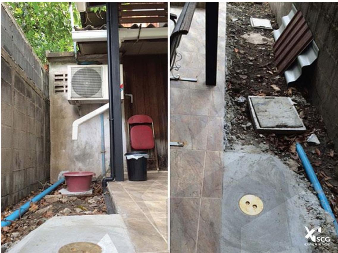
เทคอนกรีตปรับระดับพื้นของฝาท่อเสมอรระดับพื้นทางเดิน ติดตั้งท่ออากาศให้พื้นระเหยไ้ระเหย พร้อมทาสีเพื่อความเรียบร้อยสวยงาม
