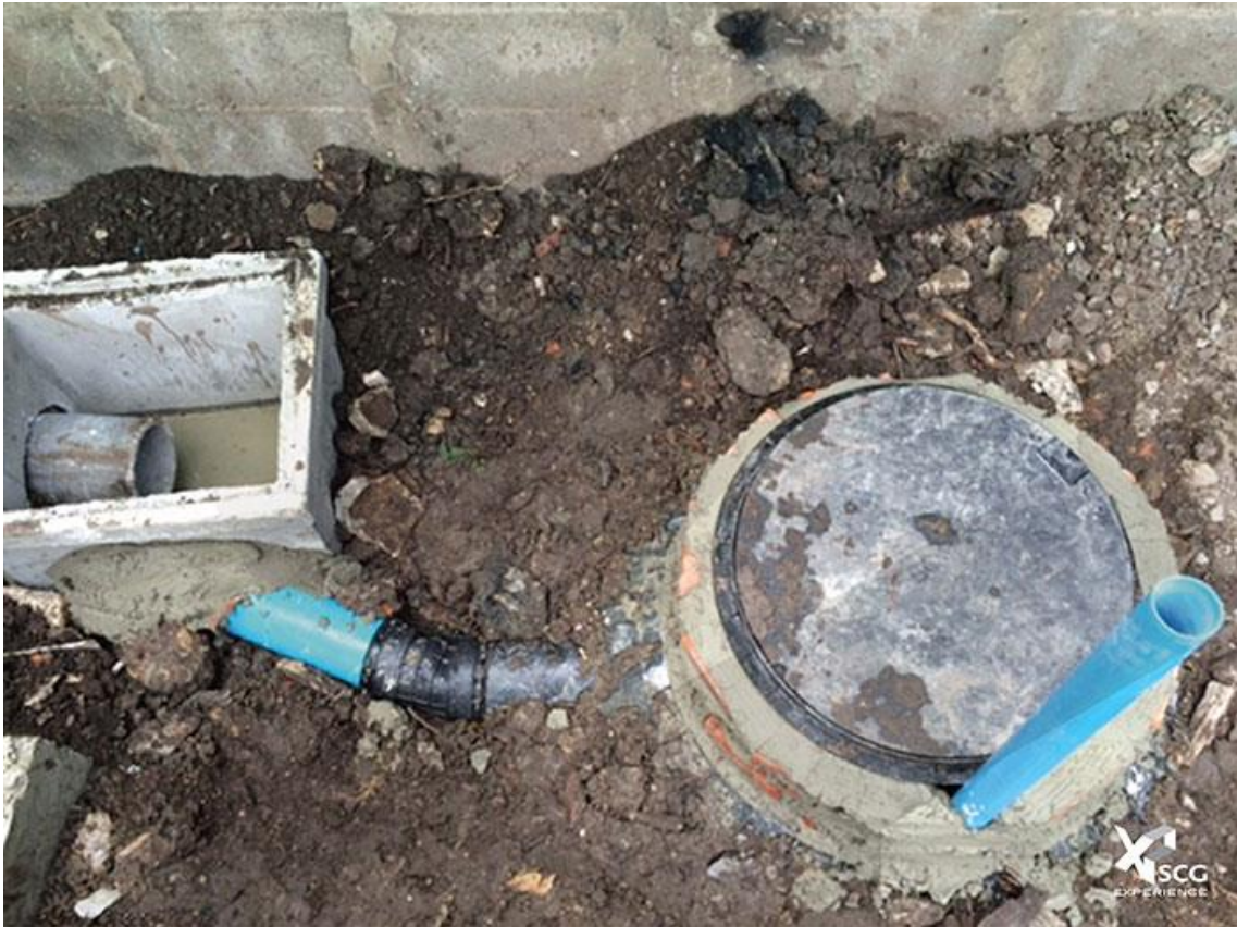
การต่อท่อถึงบำบัดสำเร็จรูปเข้ากับระบบท่อระบายน้ำเดิมของบ้าน
