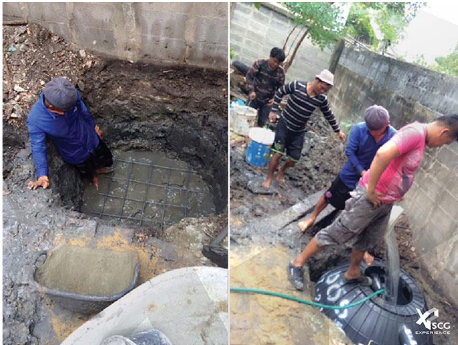
(ซ้าย) วางตะแกรงเหล็ก Wiremesh เพื่อทำการเทพื้นรองถังบำบัดด้านล่าง และ (ขวา) ใส่น้ำลงถังบำบัด เพื่อป้องกันมิให้แรงอัดของดินกดตัวถังจนเสียหาย และช่วยให้ถังไม่ลอยตัวเนื่องจากแรงดันน้ำใต้ดิน
